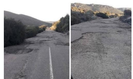
Tramos de la carretera casi intransitables:: HOY
