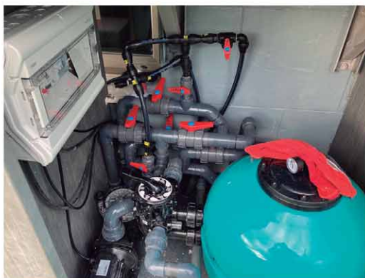
Instalación depuradora piscina
