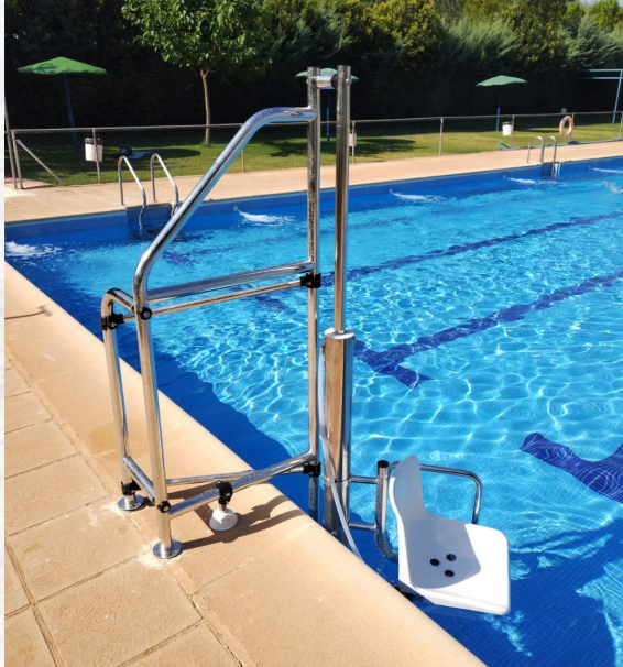
Instalación de silla elevadora en la piscina para acceso de personas con movilidad reducida.
